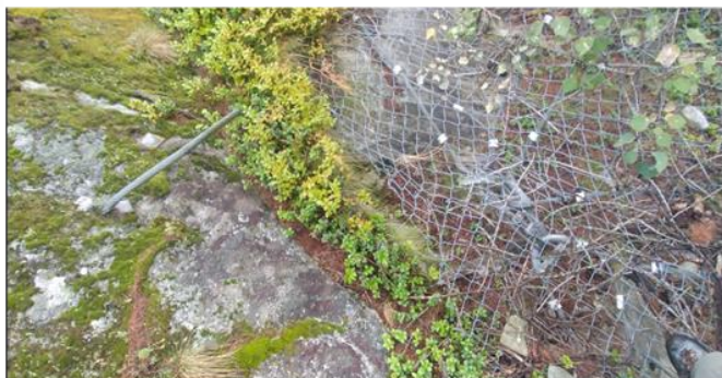
Abbildung 6: Schneenetz lose und leicht hinterfüllt, bergseitige Seilabspannung gerissen (Reihe Nr. 3 Massnahmeneinheit «Firtwald»).
