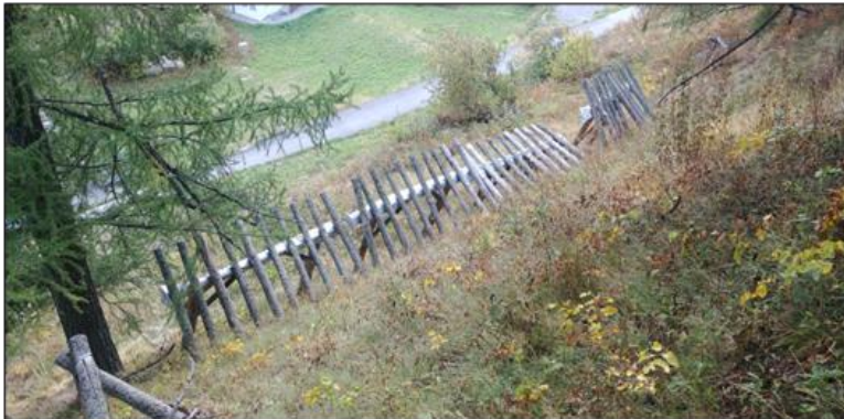
Abbildung 3: Rückzubauende Schneerechen wegen morschen Rostbalken und abgedrückten Werken (Reihe Nr. 1.2 Massnahmeneinheit «Firtwald»).
