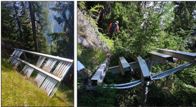
Abbildung 1 und 2: Beispiele von beschädigten Alu Schneebrücken, die zurückbauen sind. Abb. 1: Reihe Nr. 27, Abb. 2: Reihe Nr. 65 Massnahmeneinheit «Bliejendunbrand»
