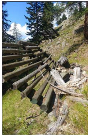
Abbildung 4: Werk Nr. 26 mit zu ersetzenden Balken. Massnahmeneinheit «Bliejendunbrand»
